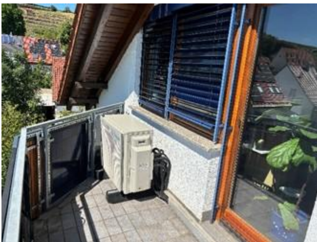
Bild 2: Im Sommer wird die Luft-Luft-Wärmepumpe zum Kühlen und Entfeuchten der Räume genutzt – besonders oft im Homeoffice im Dachgeschoss. Bildquelle: FGK e. V.
